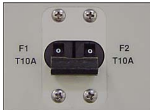
Fig. 7 Automatic mains fuse
